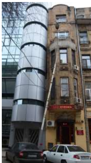
«роскошный» новодел, приведший к подвижке фундамента старого дома
