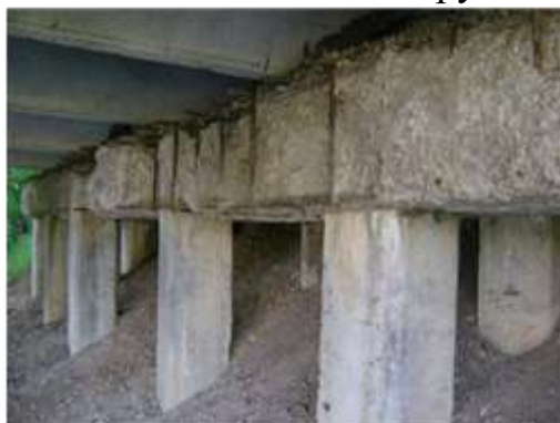
Рис. 1 Разрушение железобетонных конструкций (повреждение бетона и арматуры).
