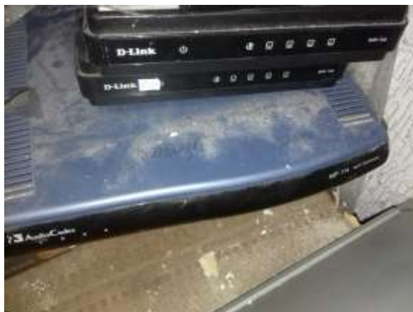
Рис.2 Маршрутизатор и коммутаторы
