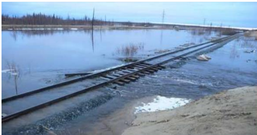
Рис. 2. Размыв земляного полотна
